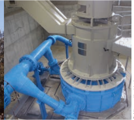
Funama, le turbogroupe à 3 injecteurs réalisé par Nippon Koei Ltd, sur la base d'une conception Mhylab, CRSM et COMATEC-CO ( Q = 586 \text{ l/s} , H_n = 205 \text{ m} , P_m = 781 \text{ kW} )
