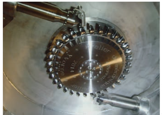
Châble II (Vionnaz, CH) : la roue Pelton à 2 injecteurs sur l'eau potable (Q = 75 l/s, Hn = 674 m, Pm = 444 kW)
