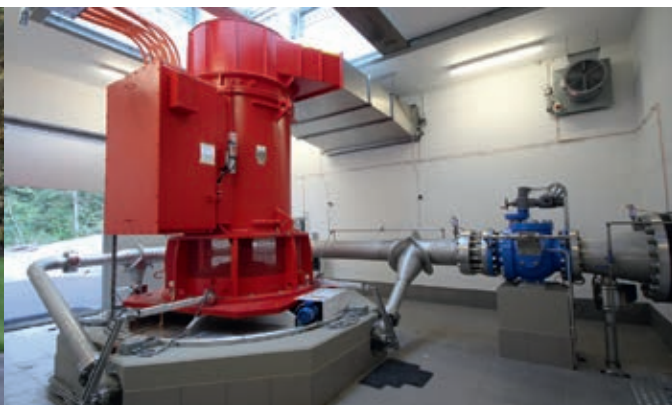
Le turbogroupe à 4 injecteurs de la centrale d'Icogne intégré au réseau d'irrigation ( Q = 473 l/s, H_n = 479 m, P_m = 1996 kW)
