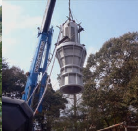
Shinsogi : la turbine bulbe réalisée par Nippon Koei, sur la base d'une conception Mhylab, CRSM et COMATEC-CO ( Q = 5,5 \text{ m}^3/\text{s} , H_n = 11,5 \text{ m} , P_m = 495 \text{ kW} )
