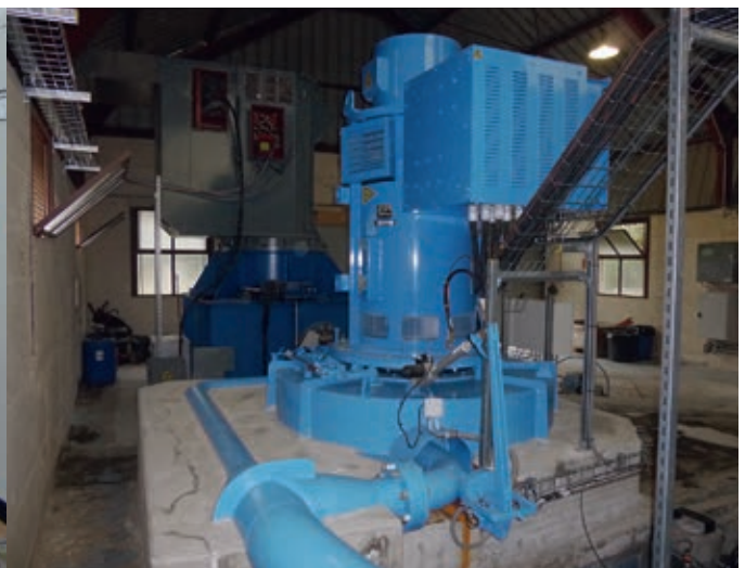
Le Lauzet (France) : 2 injecteurs, réalisé par Cerec Engineering SA sur la base d'un profil hydraulique Mhylab (Q = 186 l/s, Hn = 271 m, Pm = 432 kW)
